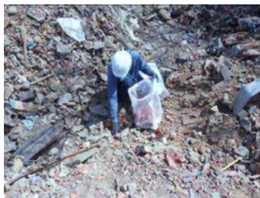
Imagen 5. Vertedero informal de residuos de demolición
