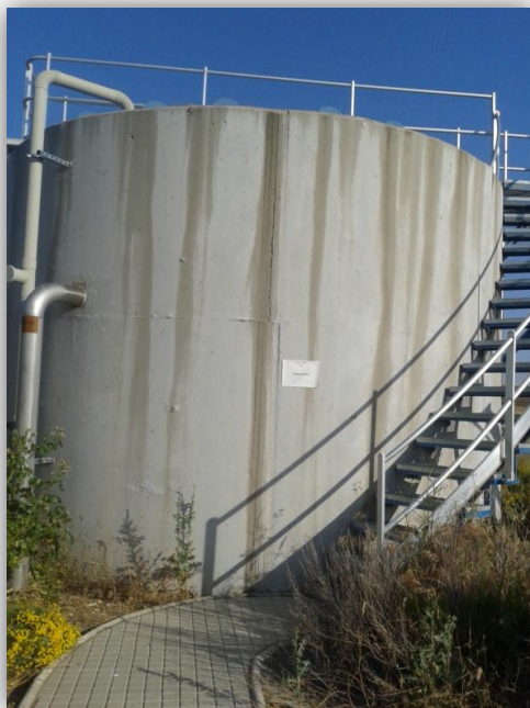
Figura 19 Espesador de lodos
