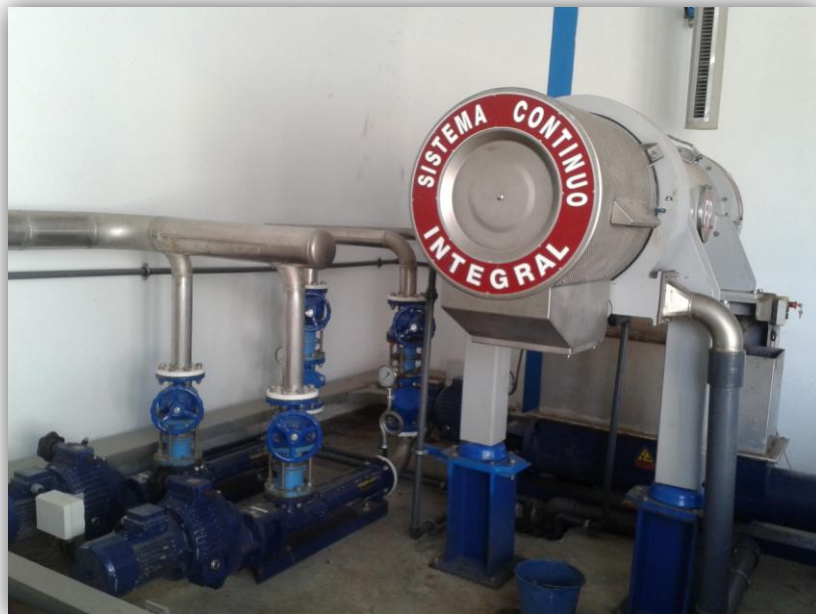
Figura 22. Centrífuga para la deshidratación de lodos
