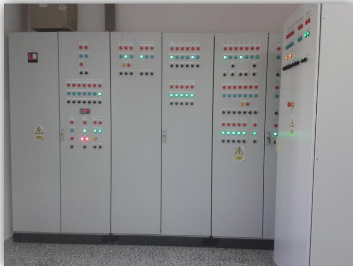
Figura 24. Cuadro de control de motores
