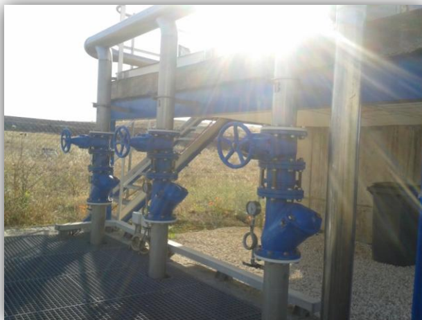
Figura 3. Conjunto de bombas
