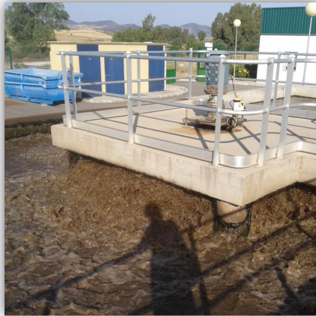
Figura 12 Uno de los cuatro agitadores de las cámaras óxicas
