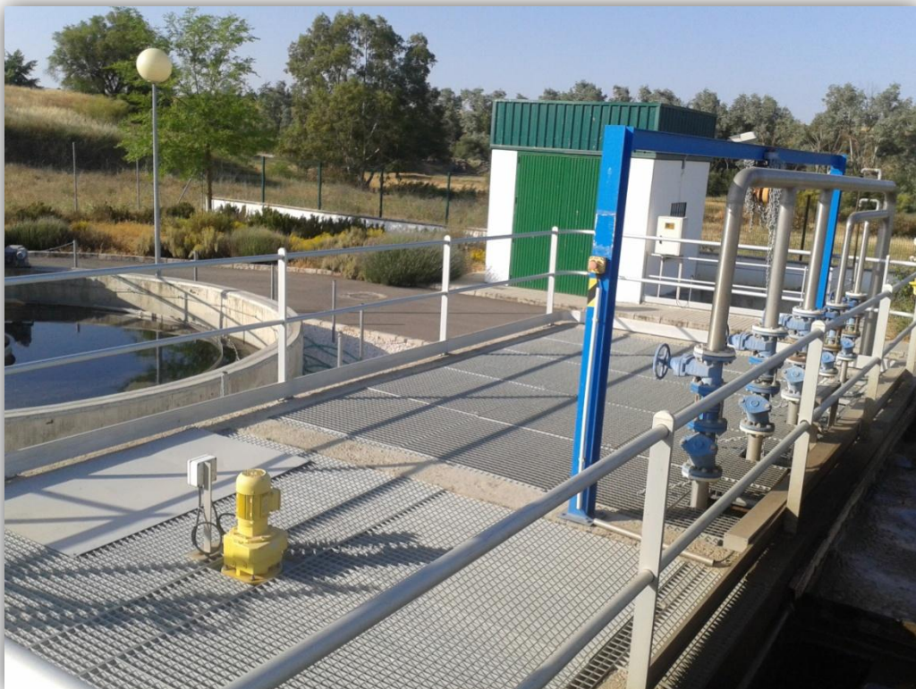
Figura 18 .3 Electrobombas sumergibles para la recirculación de lodos, 2 para la extracción de fangos en exceso y agitador para floculación.
