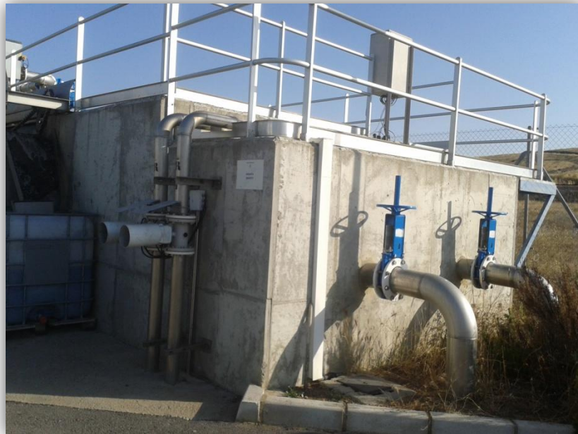
Figura 6 Desarenado-Desengrasado. Se observa además las tuberías de recirculación de lodos
