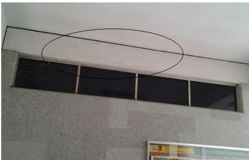
Anexo 10 Humedad en viga de techo eje 5 (K-L) módulo 3. Fuente: foto capturada el 27 de febrero de 2014
