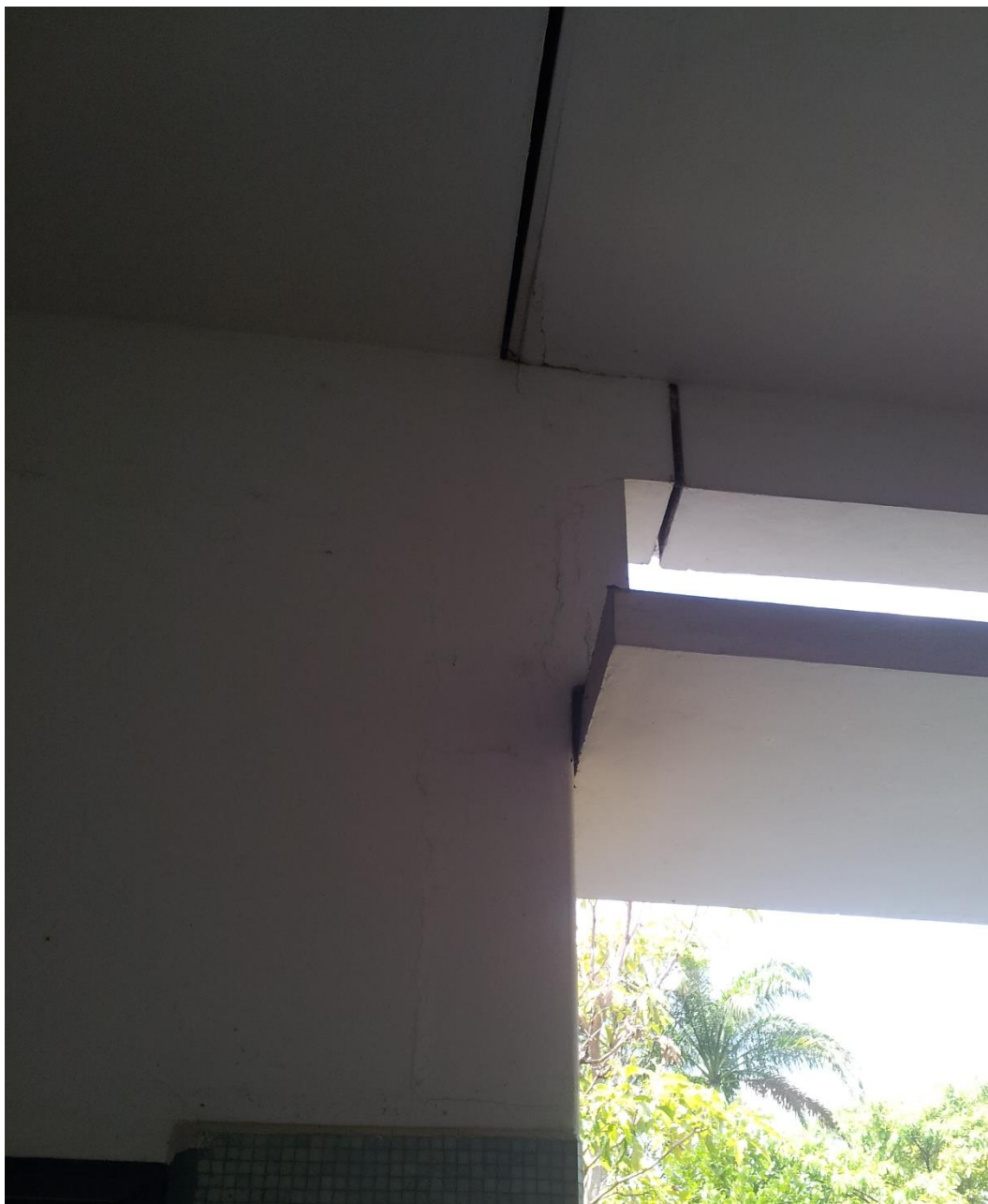
Anexo 4 Grieta en viga 16 (H'-I) y columna 16-H del módulo 3. Fuente: foto capturada el 27 de febrero de 2014
