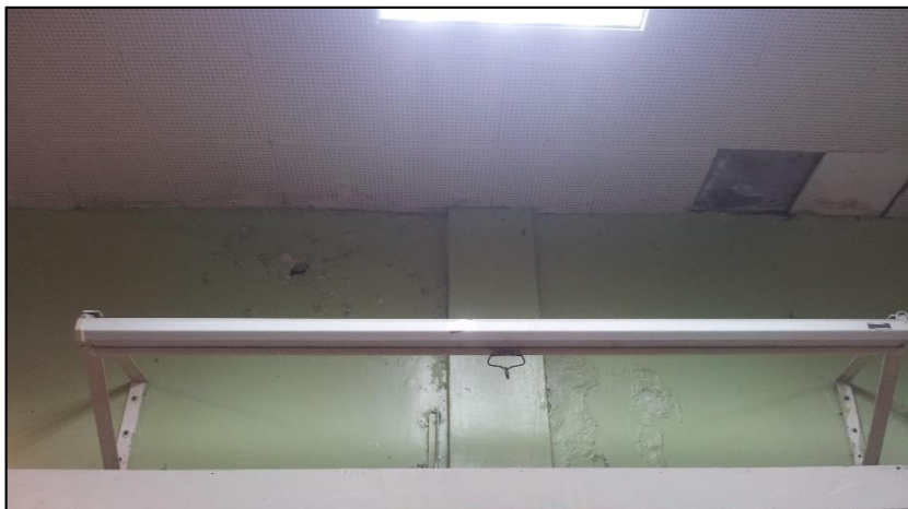
Anexo 1 Humedad en losa de techo entre ejes A-C y 1-3 del módulo 1. Fuente: foto capturada el 27 de febrero de 2014
