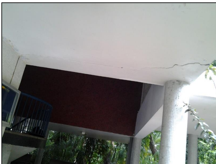
Anexo 9 Grieta en losa de entrepiso entre ejes J'-L y 5-9 del módulo 3. Fuente: foto capturada el 27 de febrero de 2014
