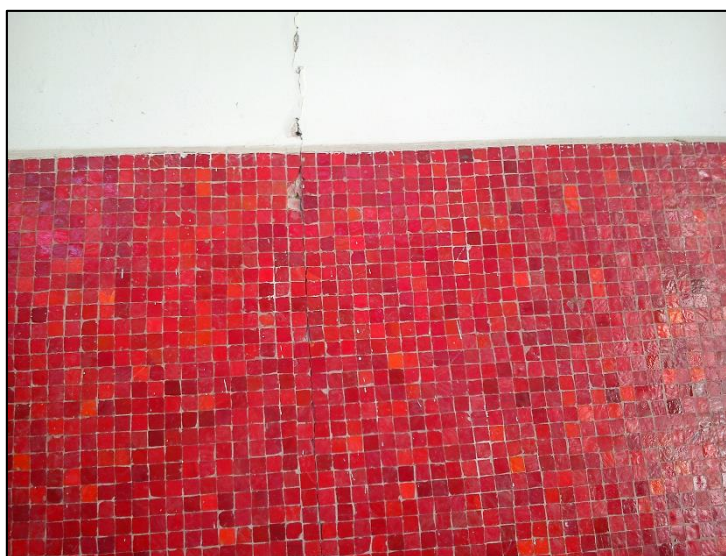
Figura 2.2 Grieta. Fuente: foto tomada el 22 de enero de 2014 en el Edificio de Aulas de la Facultad de Ciencias de la UCV
