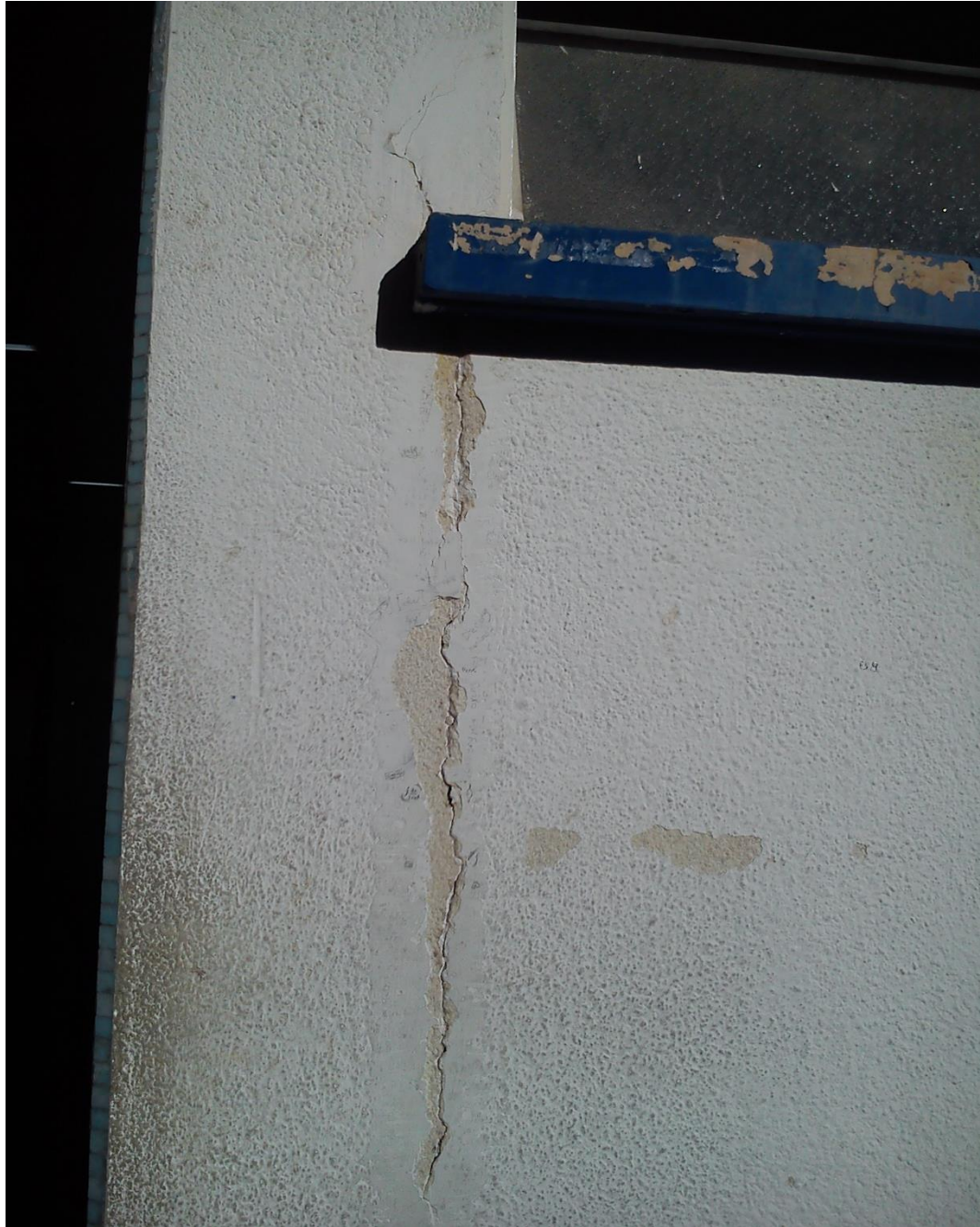
Anexo 5 Grieta en columna 16-H entre P1 y PT del módulo 3. Fuente: foto capturada el 27 de febrero de 2014
