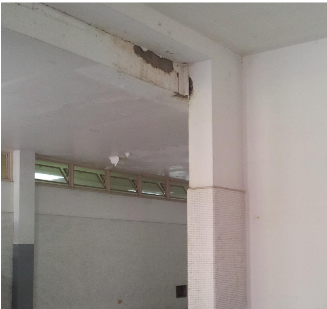
Anexo 3 Humedad en viga de techo 1V4 (E-F) del módulo 1. Fuente: foto capturada el 27 de febrero de 2014
