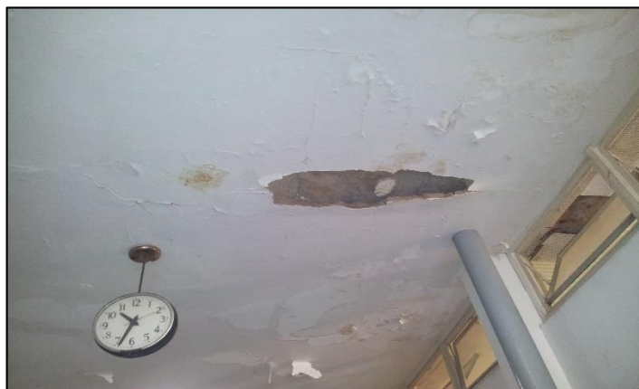
Anexo 2 Humedad en losa de techo entre ejes A-G y 3-4 del módulo 1. Fuente: foto capturada el 27 de febrero de 2014
