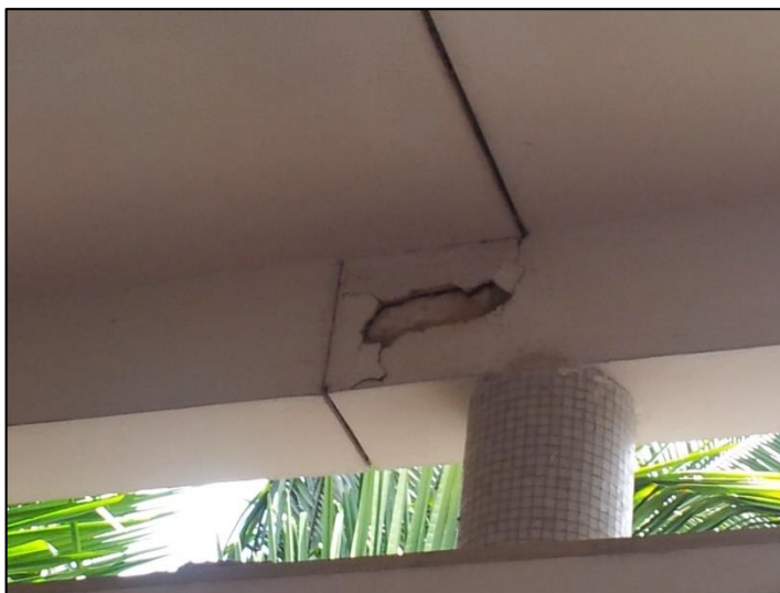
Anexo 8 Grieta en viga de techo eje 16 (N-O) del módulo 3. Fuente: foto capturada el 27 de febrero de 2014
