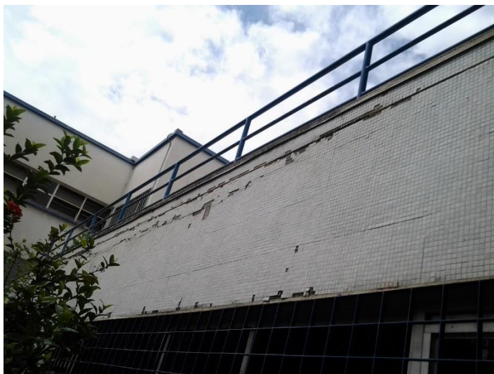
Anexo 11 Desprendimiento de mosaicos en viga en eje K' (9-14), módulo 3. Fuente: foto capturada el 27 de febrero de 2014
