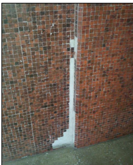
Anexo 12 Desprendimiento de mosaicos en pared del módulo 6. Fuente: foto capturada el 27 de febrero de 2014
