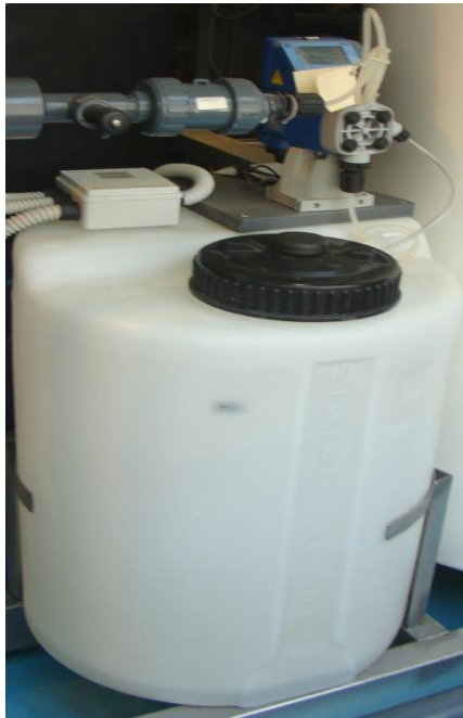
Figura N°. 13. Tanque de Hipoclorito de Sodio
