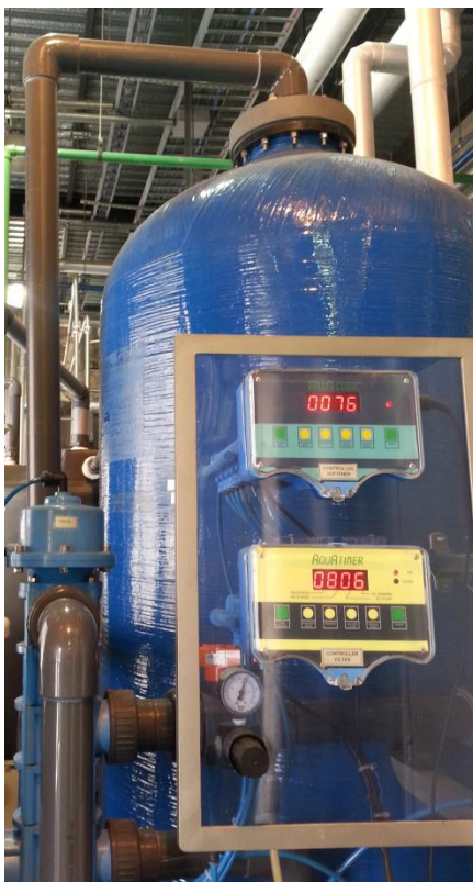
Figura N°. 15. Filtro Multimedia
