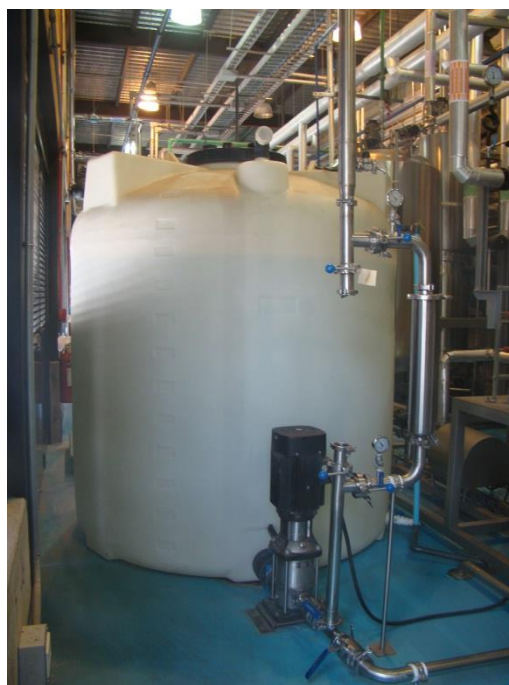
Figura N°. 16. Tanque de Almacenamiento de Agua Suavizada
