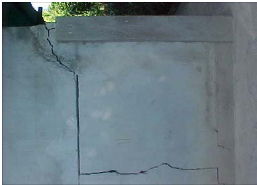
2.- Grieta en vivienda, de Maitana Alta.
