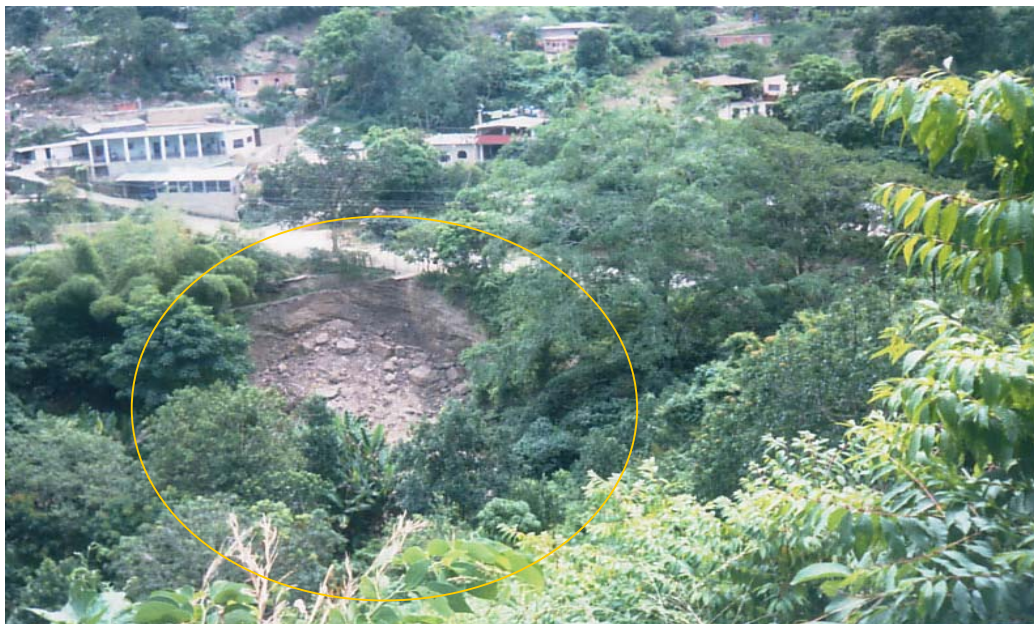
Foto 4.4. Derrumbe de un talud de la carretera en el sector San Judas
