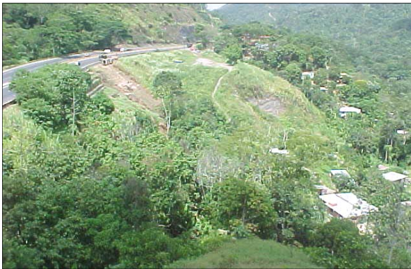
2.- Talud de Relleno de la Autopista Regional del Centro, en el Sector San Judas, es el de mayor tamaño del sector y el que a traído mayores problemas de deslizamientos.
