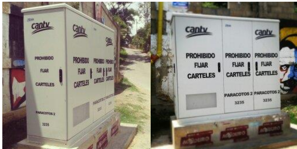
Anexo 5: Nodo de nueva generación, ubicado en el sector Los Lirios (parte baja) de la parroquia Paracotos, del estado Miranda.
