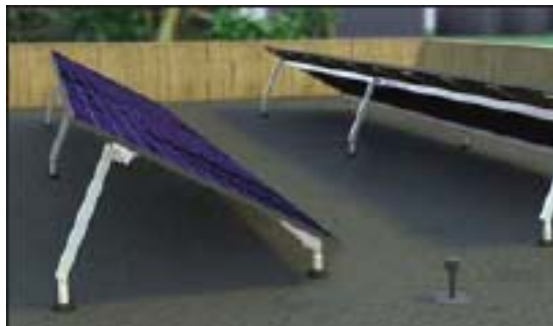
Figura 28. Estructuras de soporte de los módulos
