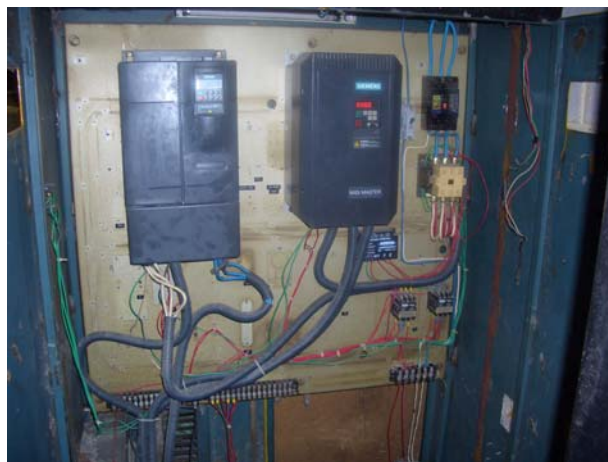
Figura 19. Equipos de accionamiento instalados en la máquina de engomado.
