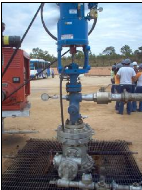
Fig. 19.- Cabezal Weatherford M2 en el pozo ES-461.
