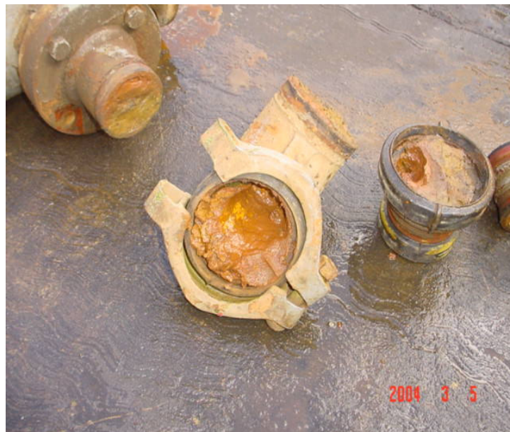
Figura 4. 4 Codo de ¼ de pulgada completamente obstruido
