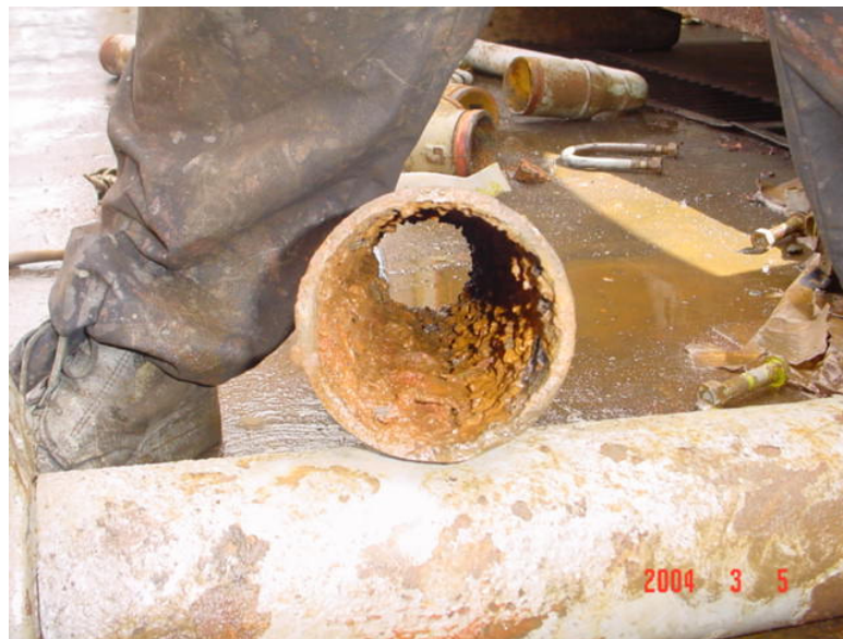
Figura 4. 1 Lodo presente en tubería del sistema de enfriamiento.
