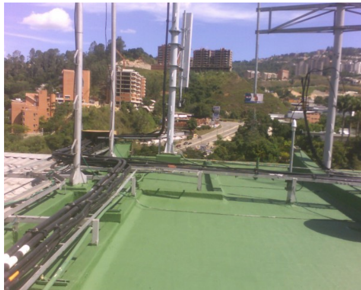
Figura 2.3: Radio base repetidora en azotea, sitio impermeabilizado con membrana asfáltica y pinturas especiales. Fuente: Mario Gorrin, fotografía tomada el 11/09/2008
