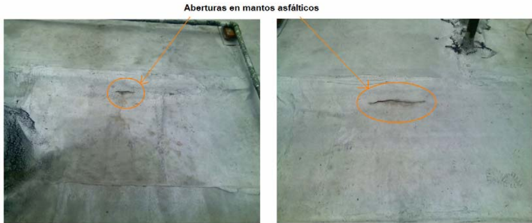
Figura 2.2.: Daños en mantos asfálticos. Fuente: Mario Gorrin, fotografía tomada el 20/08/2008
