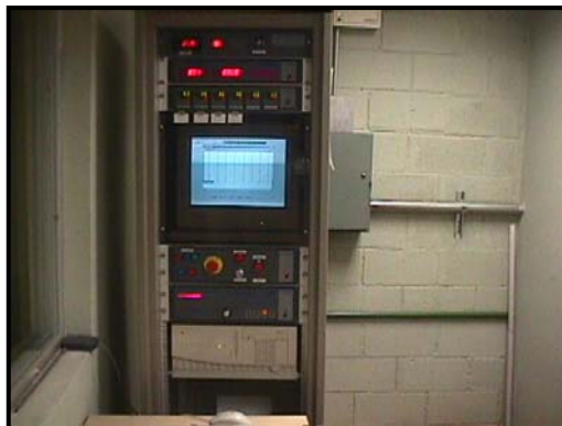
Ilustración 7. Panel de control.
