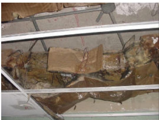
Figura 21. Ductería de Suministro.
