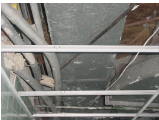
Figura 17. Tramo 1 de la Ductería de Extracción.
