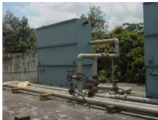
Figura 14. Torres de Enfriamiento.
