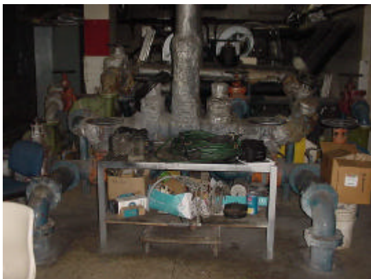
Figura 15. Sistema de Bombeo.
