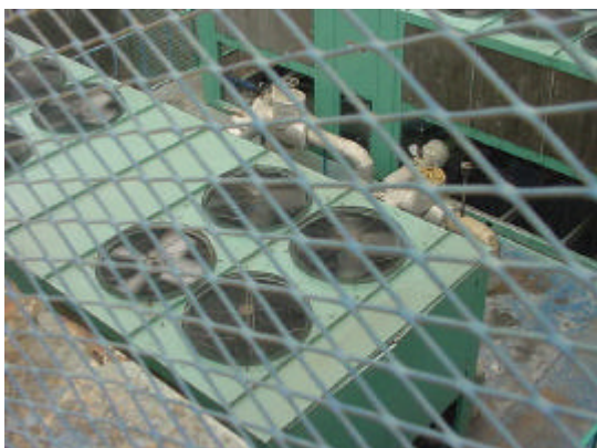
Figura 8. Moto – Ventiladores de Condensación Dañados.
