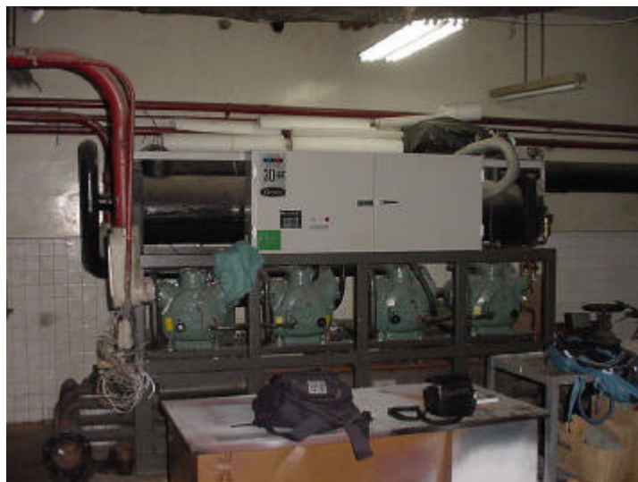
Figura 5. Chiller Nuevo (No Está en Funcionamiento).
