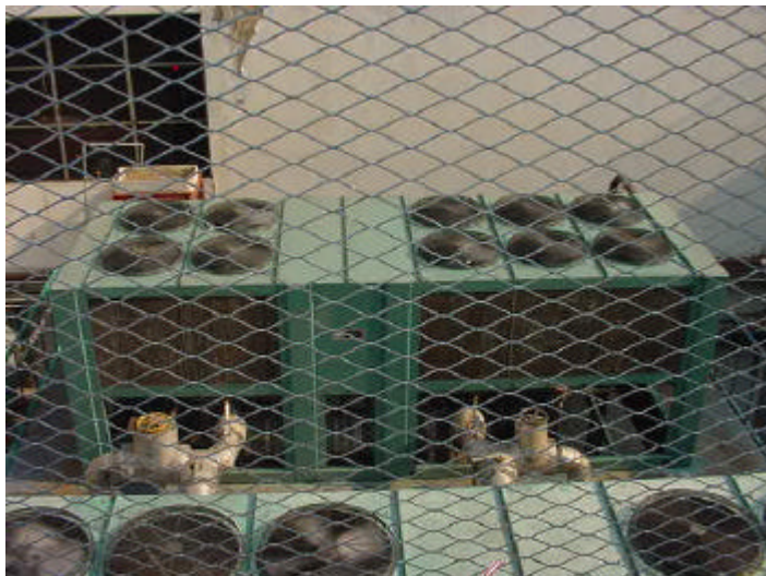
Figura 4. Chiller en Funcionamiento.
