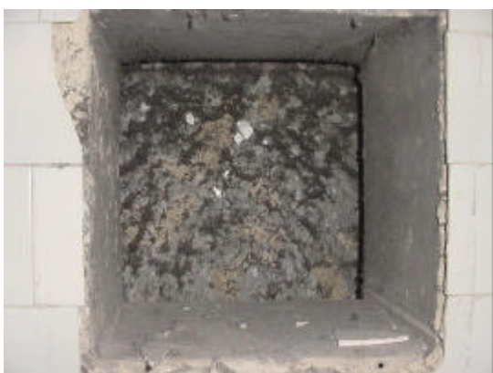
Figura 19. Sucio en Ductos de Extracción.
