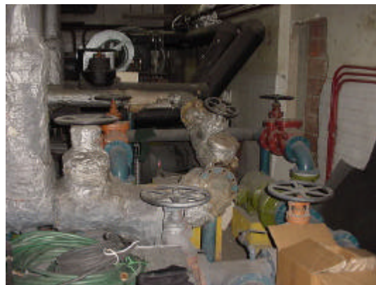
Figura 16. Sistema de Bombeo Lado Derecho del Sistema (Visto de Frente).
