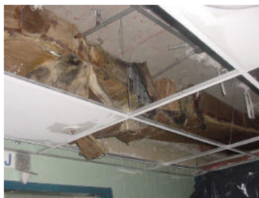
Figura 20. Fibra Aislante de la Ductería de Suministro.
