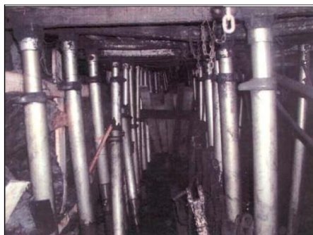
Figura N° 29. Sostenimiento Hidráulico Instalado en Mina de Carbón ñEstemple Tipo Salzgitteò.
