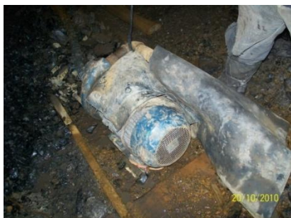
Figura N°50. Bomba de extracción de agua
