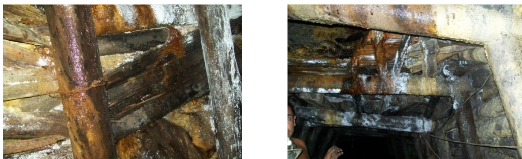
Figura N°45. Madera en descomposición por efecto del agua del frente
