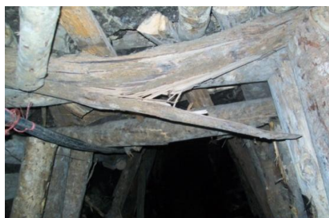
b) Madera deshilachada
