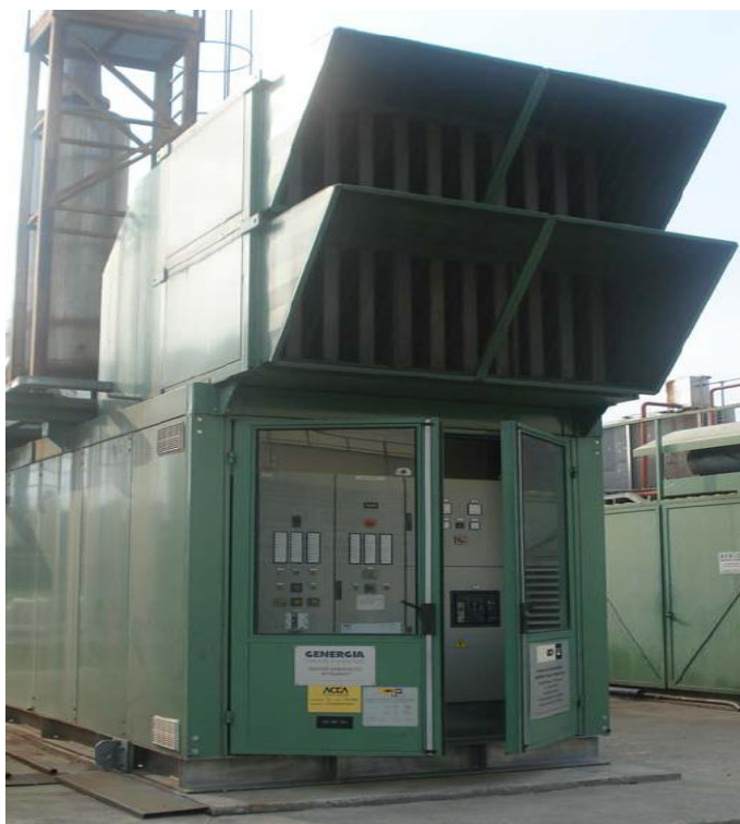
Figura 1.8: Motore per la cogenerazione
