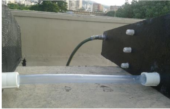
Fig. 5.0.3 Unión entre desalinizadores.
