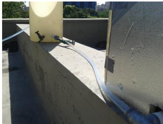
Fig. 5.0.4 Tanque de control de nivel.
