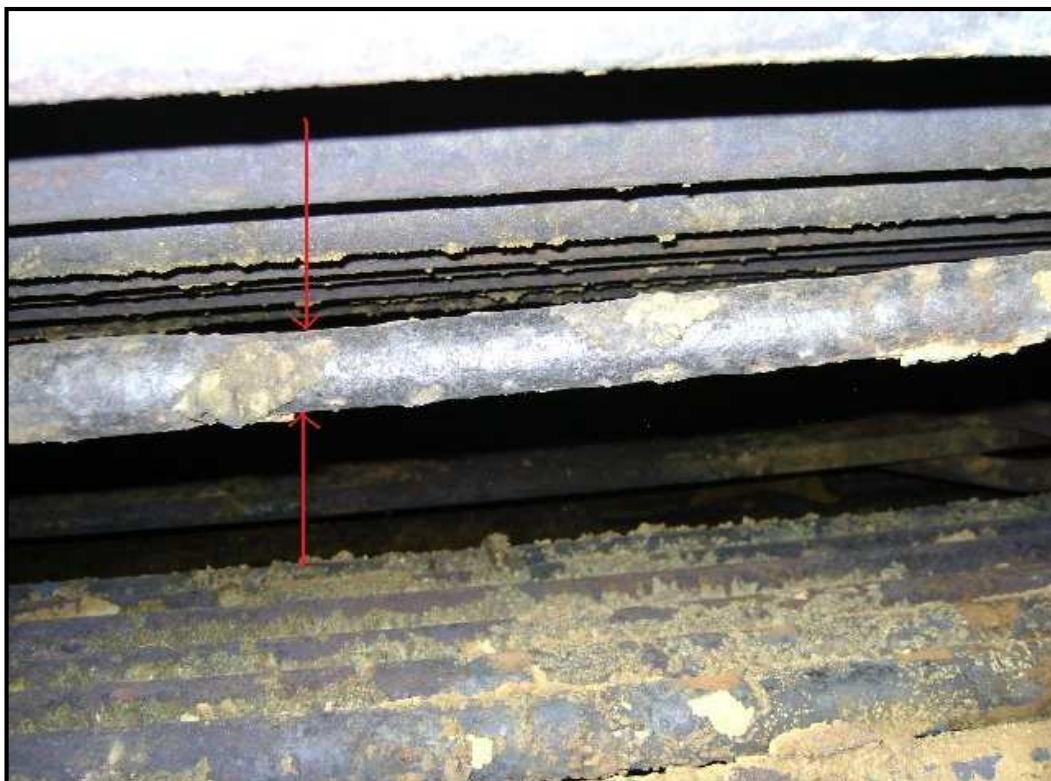
Fig. 5. 10: Disminución del Espesor de la tubería en sobrecalentadores o recalentadores Fuente: Planta Ampliación Tocoa
