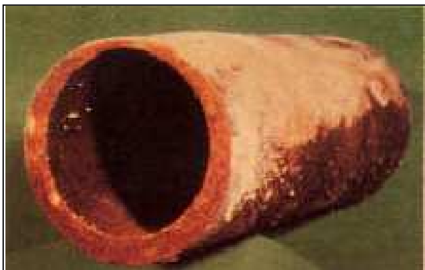
Fig. 5. 9: Corrosión en Tubería Fuente: Manual de NALCO
