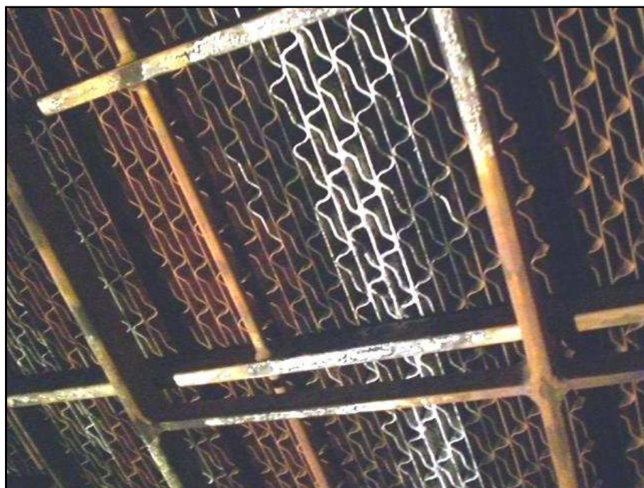
Fig. 5. 12: Superficies de transferencia de calor del precalentador de aire luego de un lavado con soda cáustica Fuente: Planta Ampliación Tocoa
