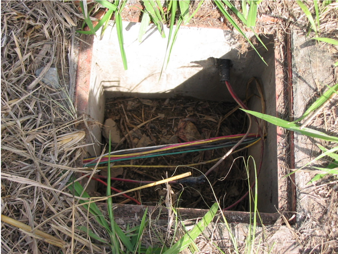
Figura 5.9. Visualización del cableado en el SEV-8 para AB/2 8m
