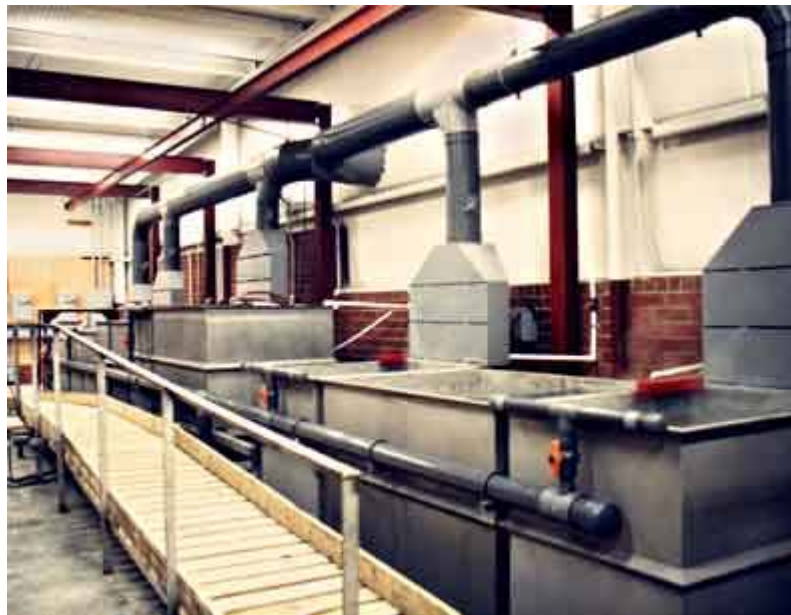
Figura 53. Estación de electropulido con etapas de limpieza previa
