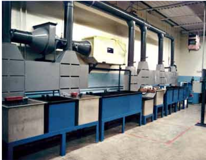
Figura 69. Estación de limpieza y electropulido.
