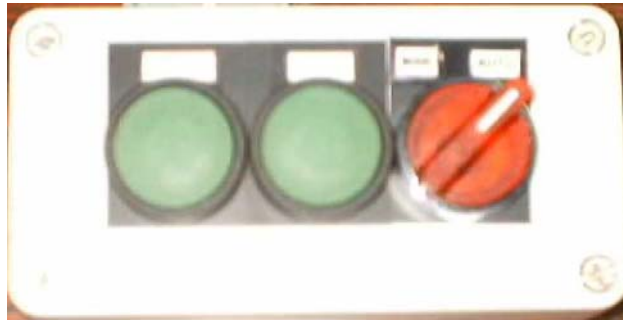
Figura 23. Estación de pulsadores.
