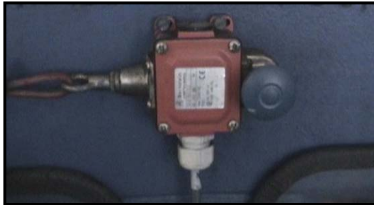
Figura 5.16.8 Interruptores de parada de emergencia.
