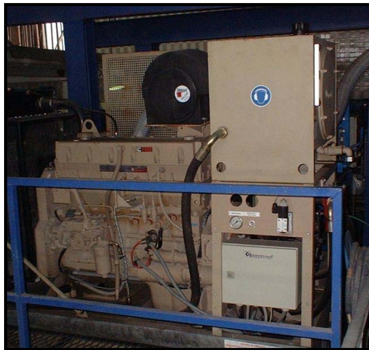
Figura 5.11 Motor de emergencia.
