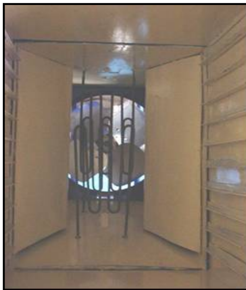
Fig. 5.4. Interior de la Sección de Calentamiento (Fuente: Los Autores)
