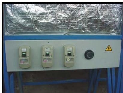
Fig. 5.5. Frente del Tablero Eléctrico (Fuente: Los Autores)
