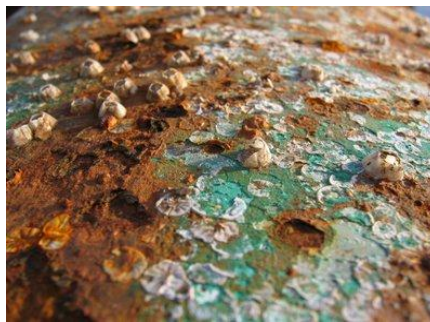
Figura 2.11 Desgaste por Corrosión (Pernía, 2006).
