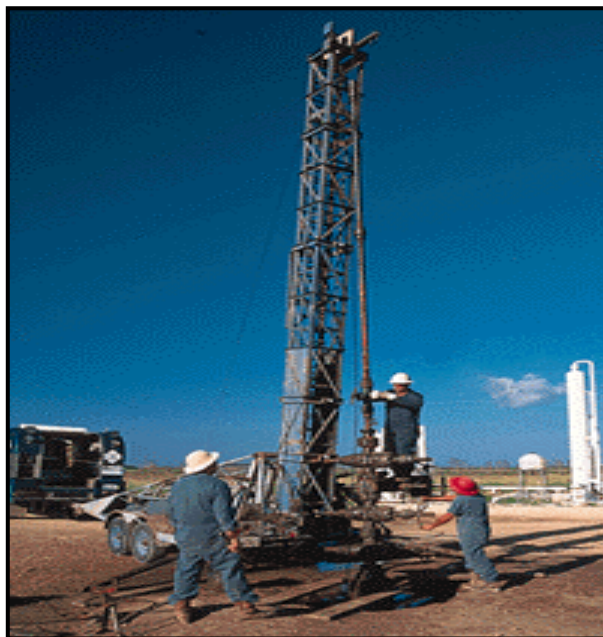
Figura 2.1 Equipo perforador (Pernía, 2006)
