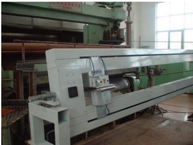
Anexo 36. Sonda beta instalada en un laminador de bobina.
