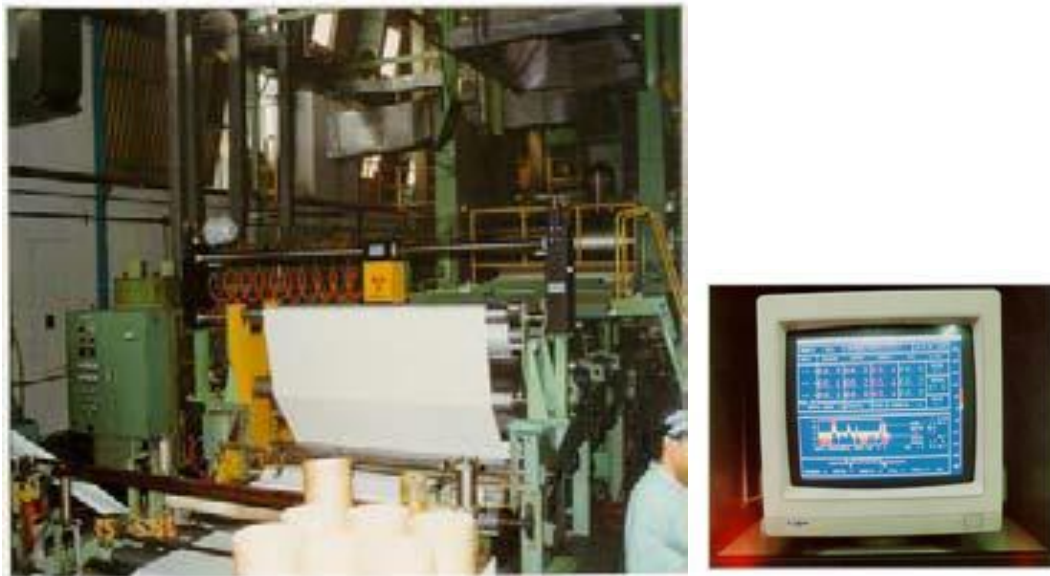
Anexo 35. Medidor de espesor instalado en fábrica para la medición de la zona-Peso de películas PWC calandrados.
