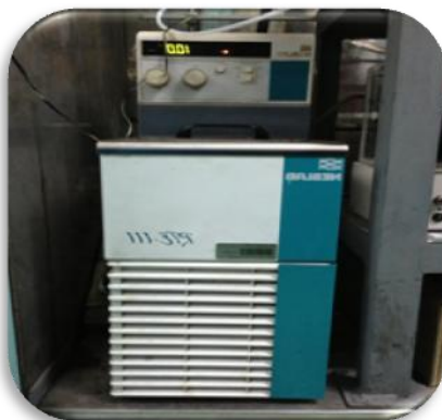
Figura N°50 Sistema de enfriamiento del condensador
