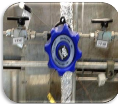
Figura N°48 Válvula controladora de presión PCV-01.
