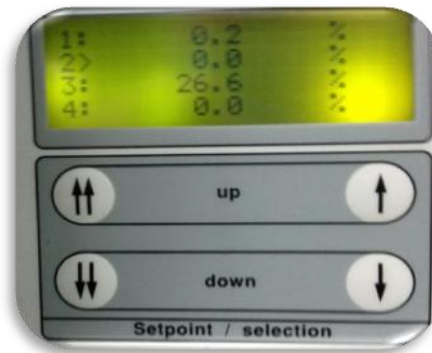
Figura N°54 Panel del controlador de flujo FI-01.
