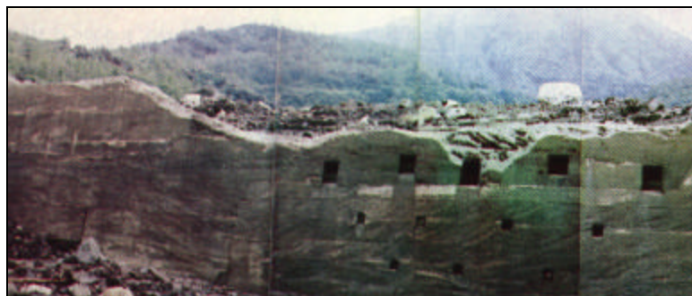
Desgaste importante en la cresta vertedora.
