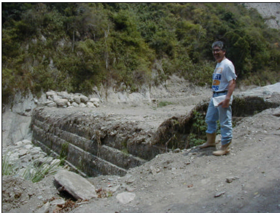
Fig. Nº 45. Colmatación de estructura diseñada para la disipación de energía. Qda. Osorio.
