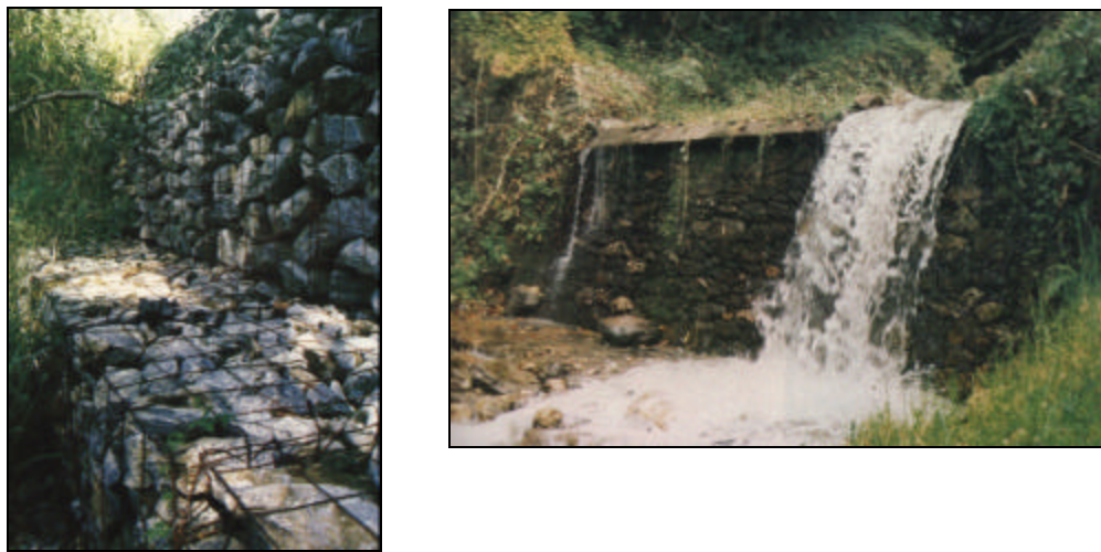
Fig. N° 69. Presa de gaviones. (Tomado de VILLAR, 1993).
