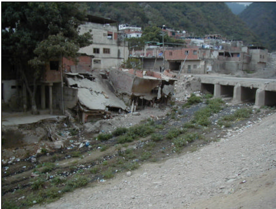
Fig. Nº 40. Viviendas construidas al borde del río, irrespetando la protección lateral del cauce. Qda. Curucuti.
