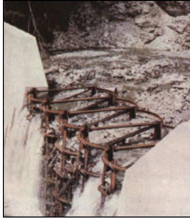
Presas de enrejado en forma de cesta Austria.
