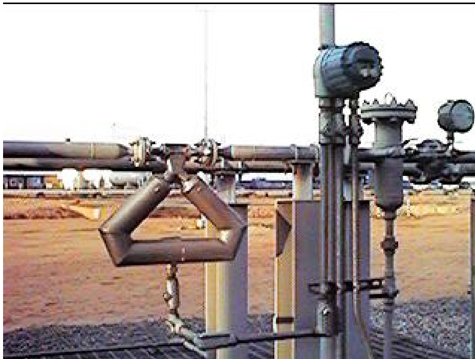
Figura 3.13: Medidor Coriolis instalado en planta de compresión POGAP II
