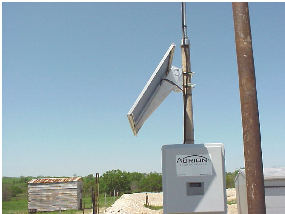
Figura 3.16 : Medidor de Flujo Electrónico instalado en planta Santa Rosa
