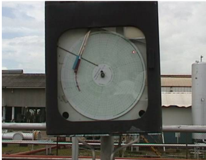
Figura 3.14: Registrador Mecánico Barton
