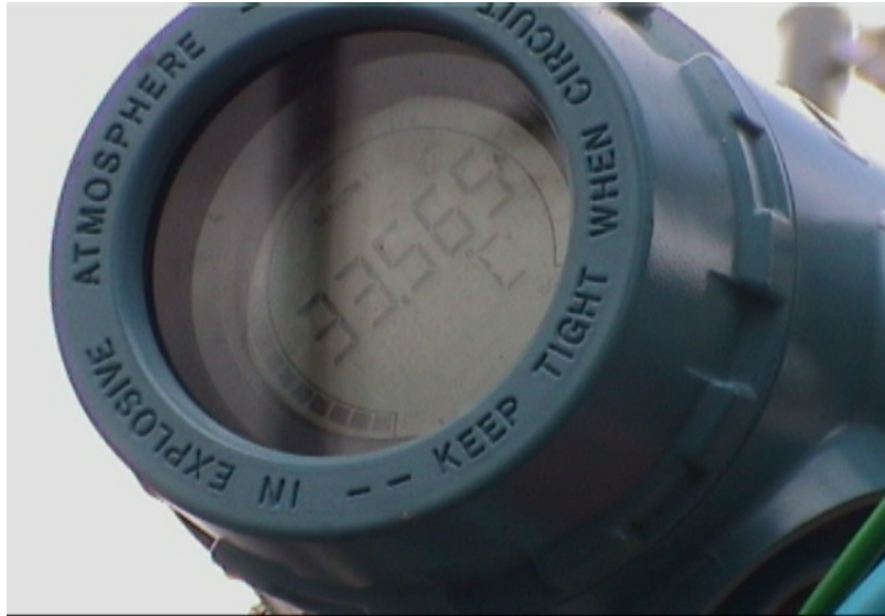
Figura 3.15: Transmisor de Temperatura instalado en Jusepín
