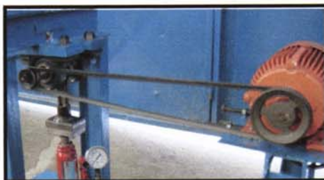
Figura 4.2. Vista frontal del sistema de potencia
