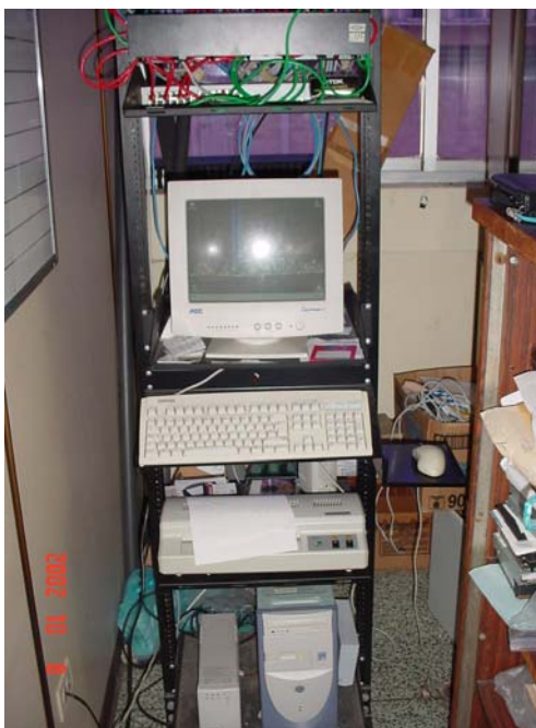
Fig. 5 Cuarto de Cableado Edf. Capitanía de Puertos
