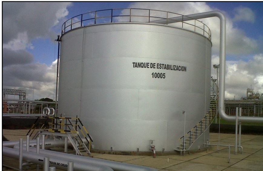
Figura 3.7 Tanque de estabilización 10.005, (TK-10.005)
