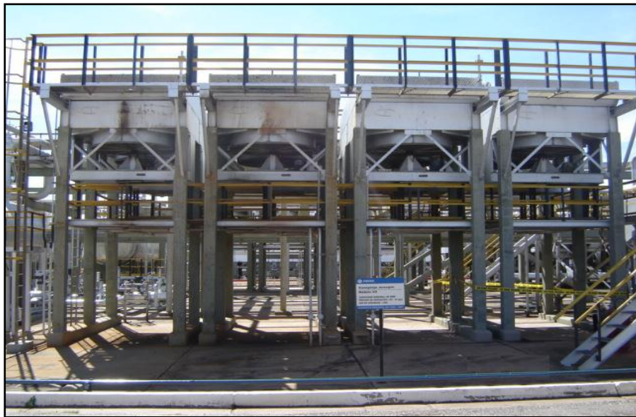
Figura 3.9 Enfriadores de gas módulo VII
