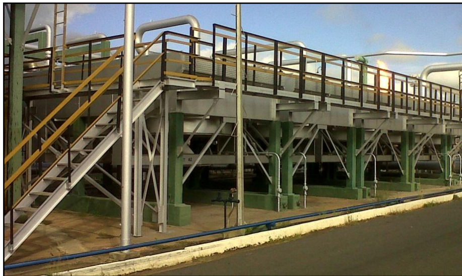
Figura 3.8 Enfriadores de Crudo, Módulo VII
