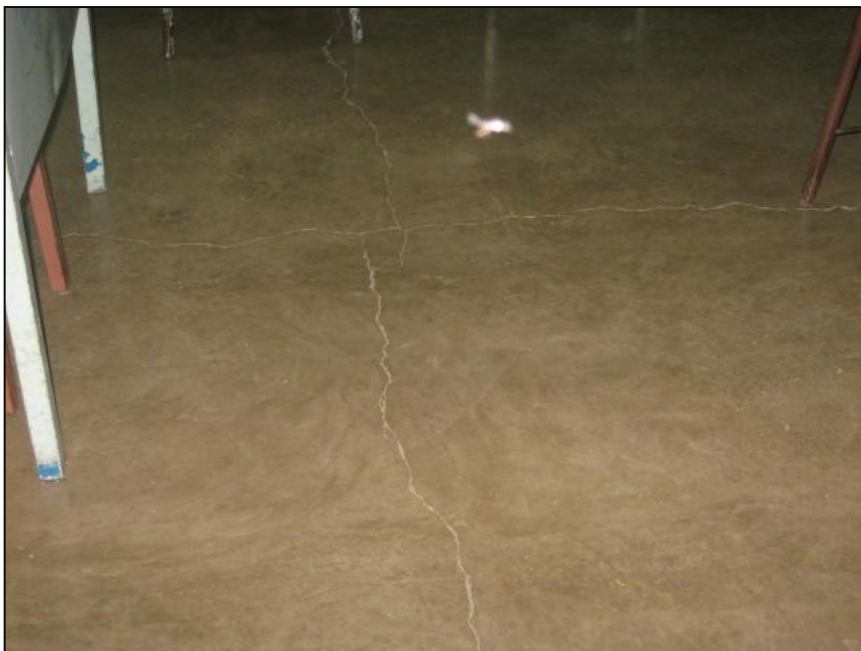
Figura 7.1.21 Grietas en la losa de entrepiso
