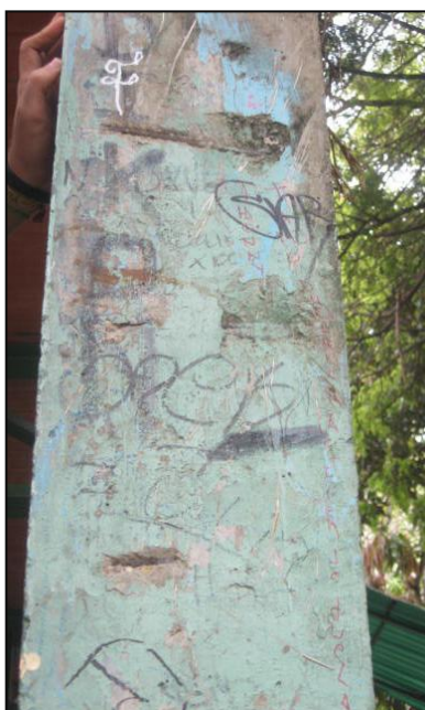
Figura 7.1.16 Pérdida de recubrimiento en la columna A-15
