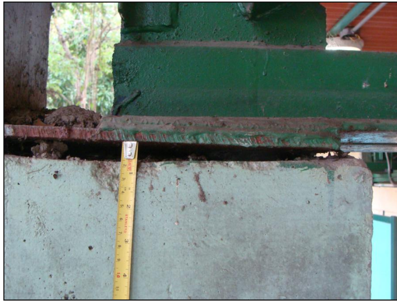
Figura 7.1.13 Separación entre el apoyo y la plancha de anclaje de la cercha Fuente: Los Autores
