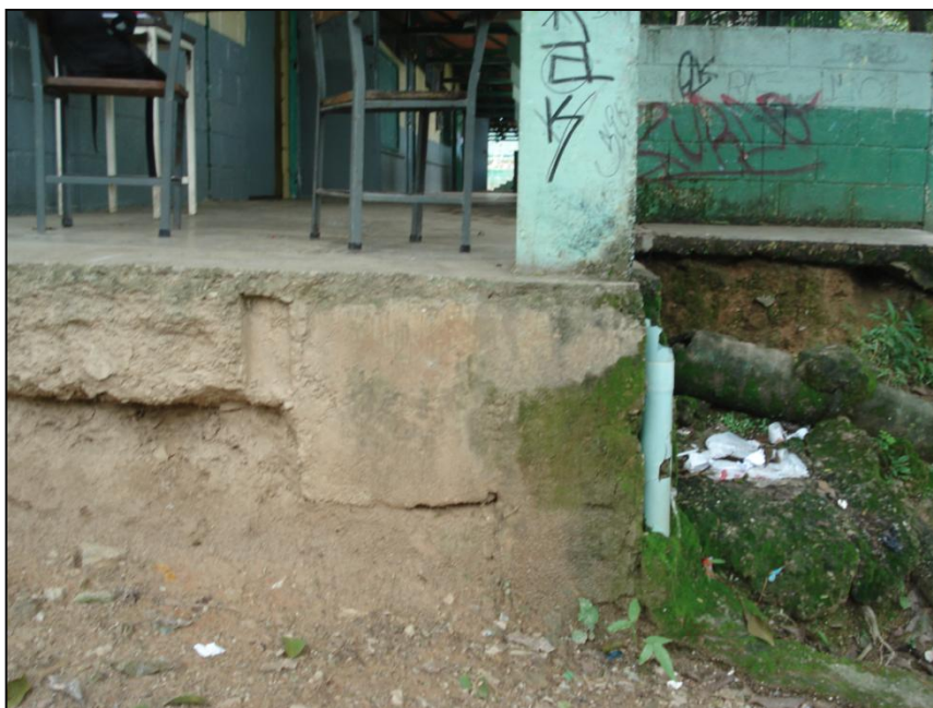
Figura 7.1.15 Parte de fundación y viga de riostra expuesta en el eje 15
