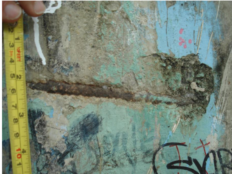
Figura 7.1.17 Exposición del acero transversal, columna A-15
