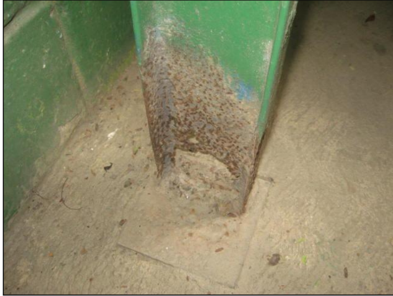
Figura 7.1.9 Base de un perfil de apoyo del módulo de escalera 2, ubicada entre ejes 11 y 12.
