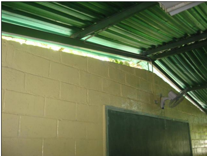
Figura 7.1.20 Separación de la mampostería de la estructura Fuente: Los Autores
