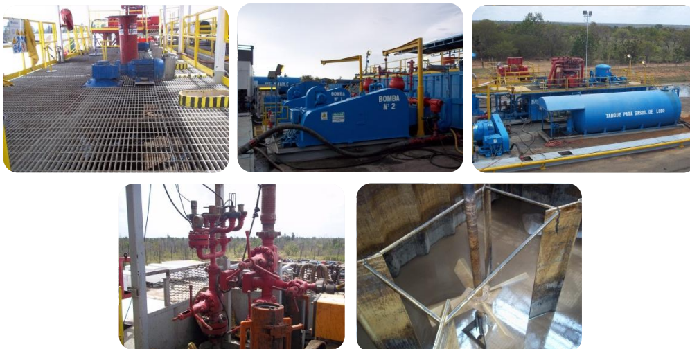
Figura 19 - Equipos de circulación [Aristimuño y Briceño, 2012]
