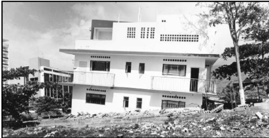
Figura II.11 Casa afectada por el fenómeno de licuación. Caraballeda, Litoral Central, año 1967.
