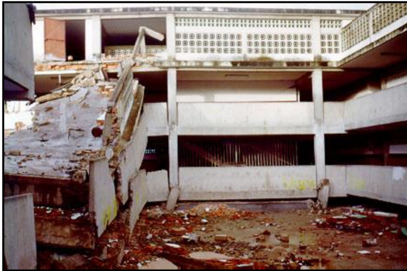
Figura II.15 Daños Estructurales en Edificación. Cariaco 1997.
