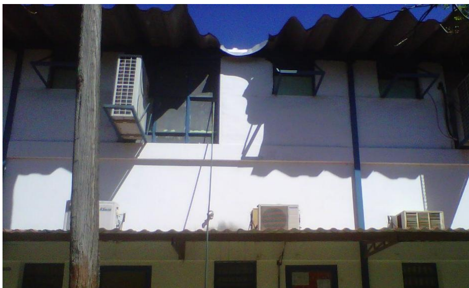
Figura I.2. Estado Techo Galpón 2 Lado Sur. Fuente: Elaboración Propia. Fecha: 22/09/2011
