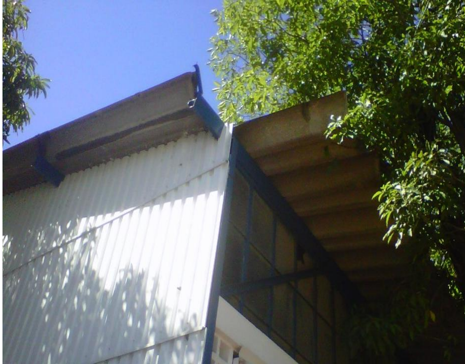
Figura I.4. Estado Techo Galpón 1 Lado Norte.
