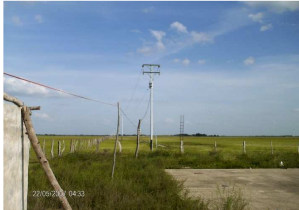
Figura 2. Red de alumbrado de la comunidad Los Manglesitos
