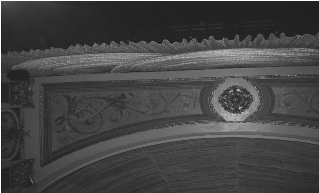
Plafón del proscenio, estado actual de la boca del escenario. Foto: cahchee.
