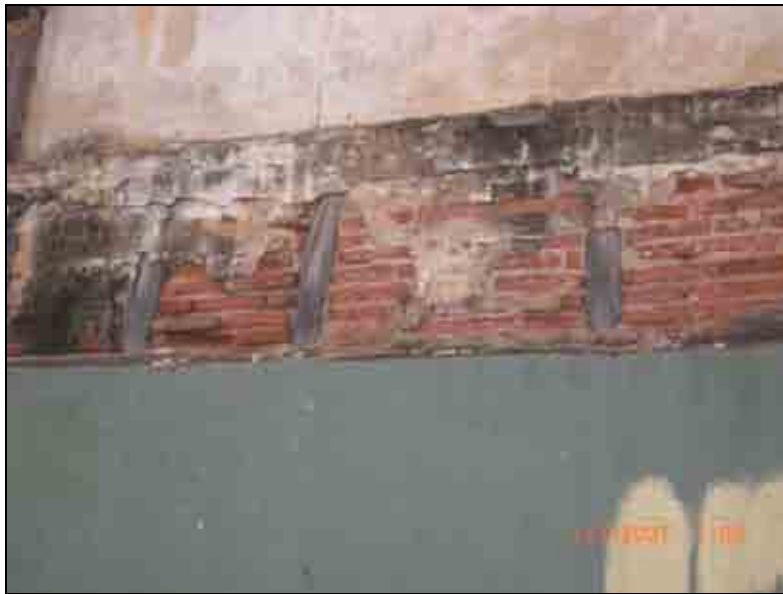
Figura N° 119. Restos del templo masónico de Maracaibo, se aprecian materiales como ladrillo y madera para los muros de carga.(Foto: Jipson Briceño, 2010).
