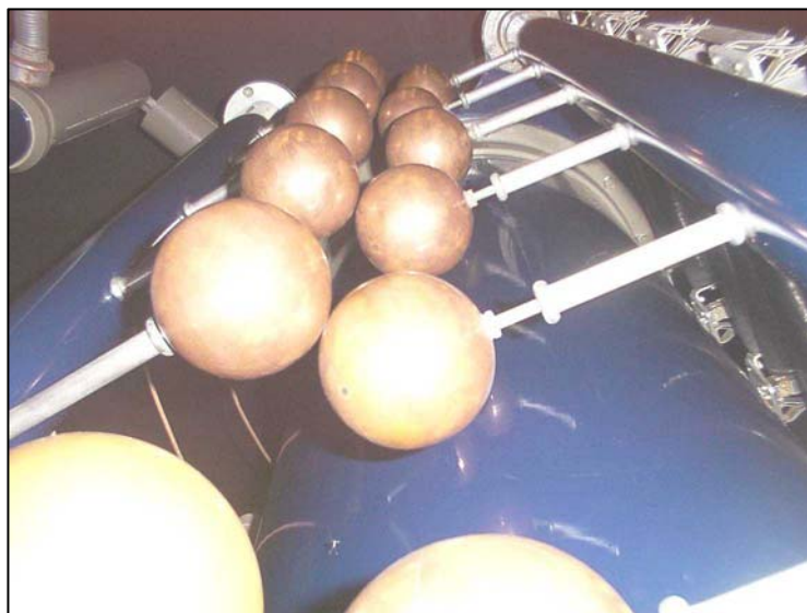
FIGURA 12: Columnas de esferas del generador de impulso (6 pares de esferas)
