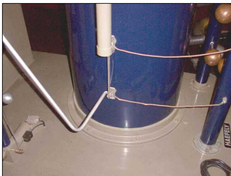
FIGURA 14: Resistencia para carga DC de capacitores y varilla delgada para descarga
