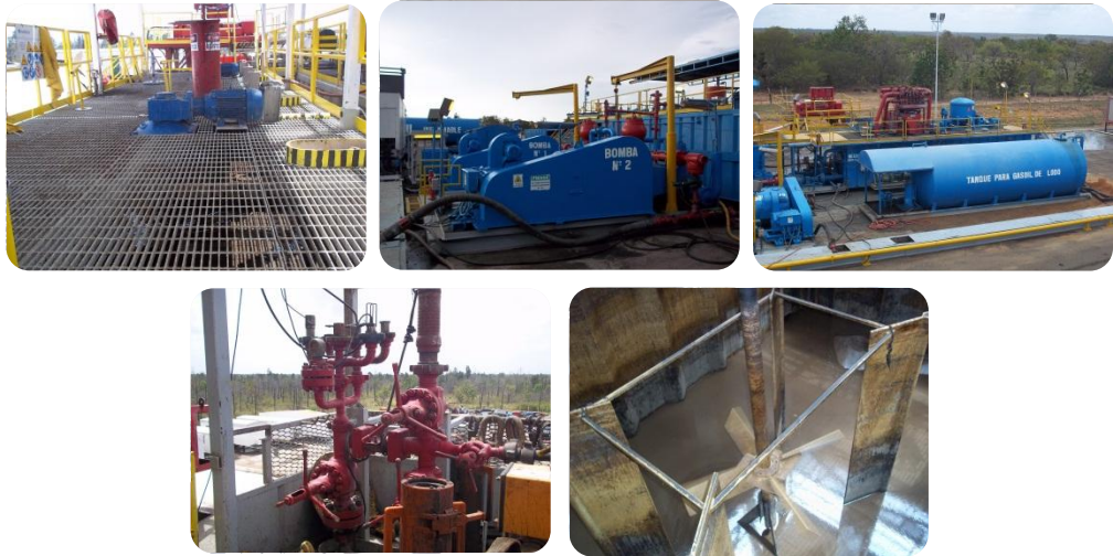
Figura 19 - Equipos de circulación [Aristimuño y Briceño, 2012]
