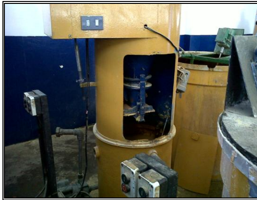
Figura IV.5. Dosificador de sulfato de aluminio de la planta de tratamiento Pie de Cerro.
