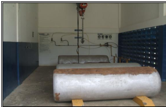
Figura IV.6. Sala de cloración de la planta de tratamiento Pie de Cerro.
