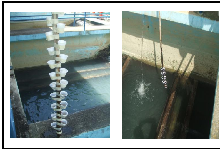
Figura II.7. Instrumento utilizado para medir la expansión del lecho en los filtros, P.T. de Pie de Cerro.
