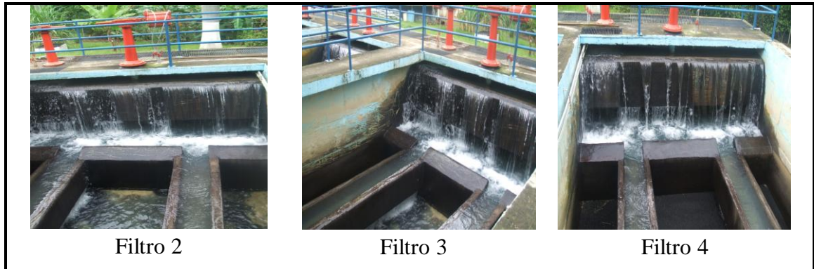
Figura IV.23. Filtros de la planta de tratamiento Pie de Cerro operando con mínimo caudal.
