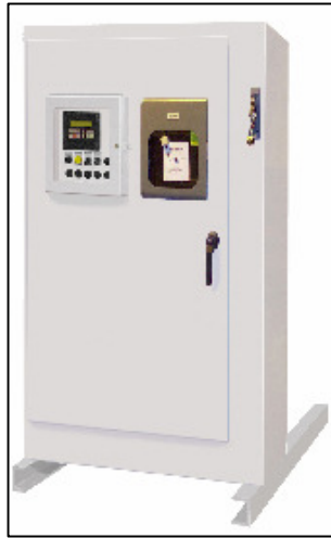
Fig.- 2.7 Variador de Frecuencia [26]
