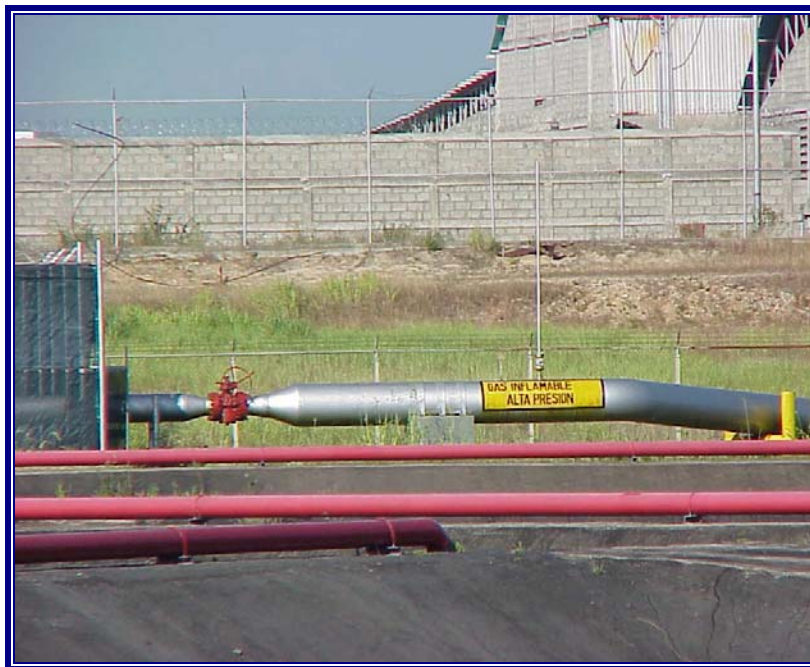
Fig. N° 18: Sub-estación principal de gas.
