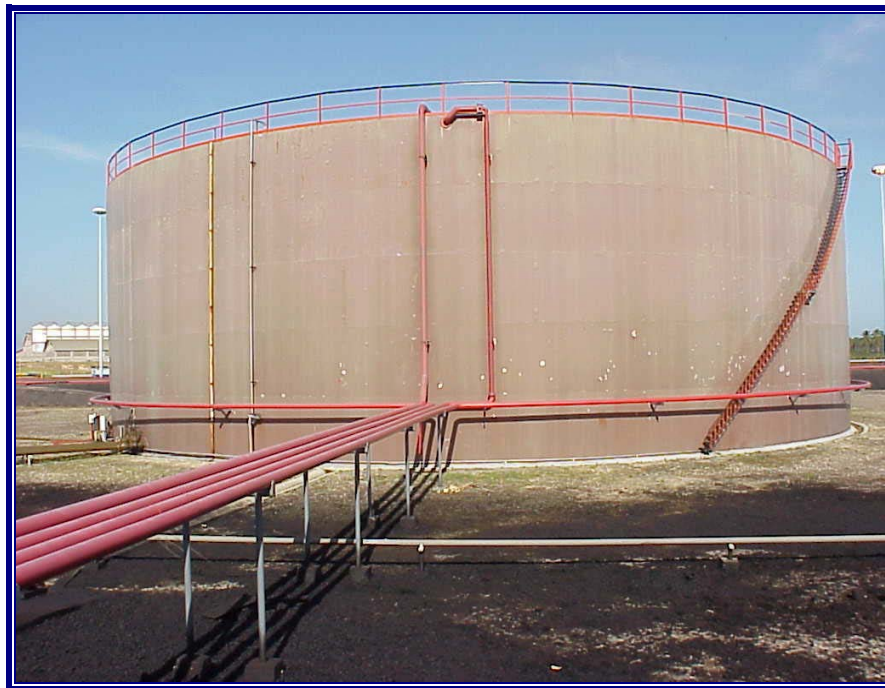
Fig. N° 19: Tanque de combustible liviano (Gas-oil)
