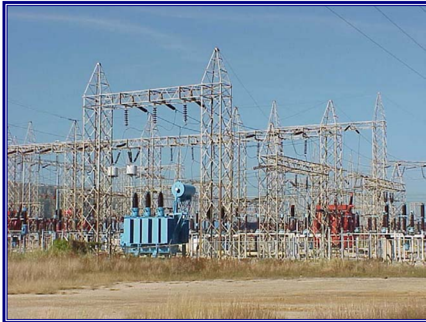
Fig. N° 21: Sub-estación Planta Centro 400/230/115 kV
