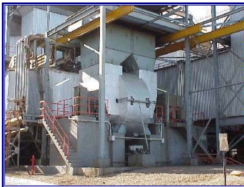
Fig N°12: Ventilador de tiro Forzado (unidad N° 3, 4 y 5)
