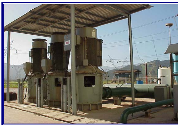
Fig. N° 13: Bombas secundarias de agua refrigeradora
