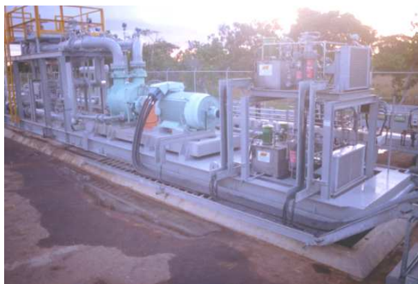
Figura 22. Arreglo de bomba multifásica en SINCOR C.A.
