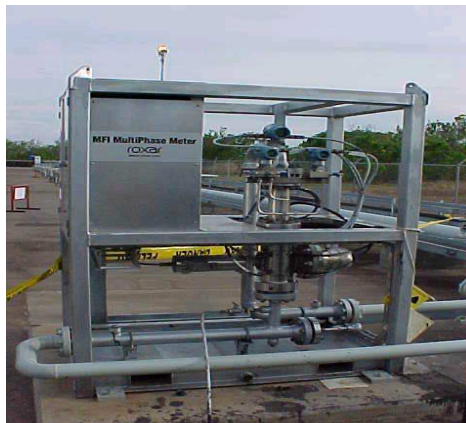
Figura 41. Medidor multifásico Roxar en las macollas.
