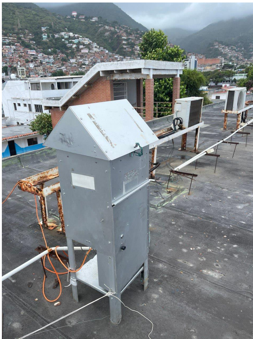
Figura 16: Muestreador de gran volumen instalado en el Puerto de La Guaira.
