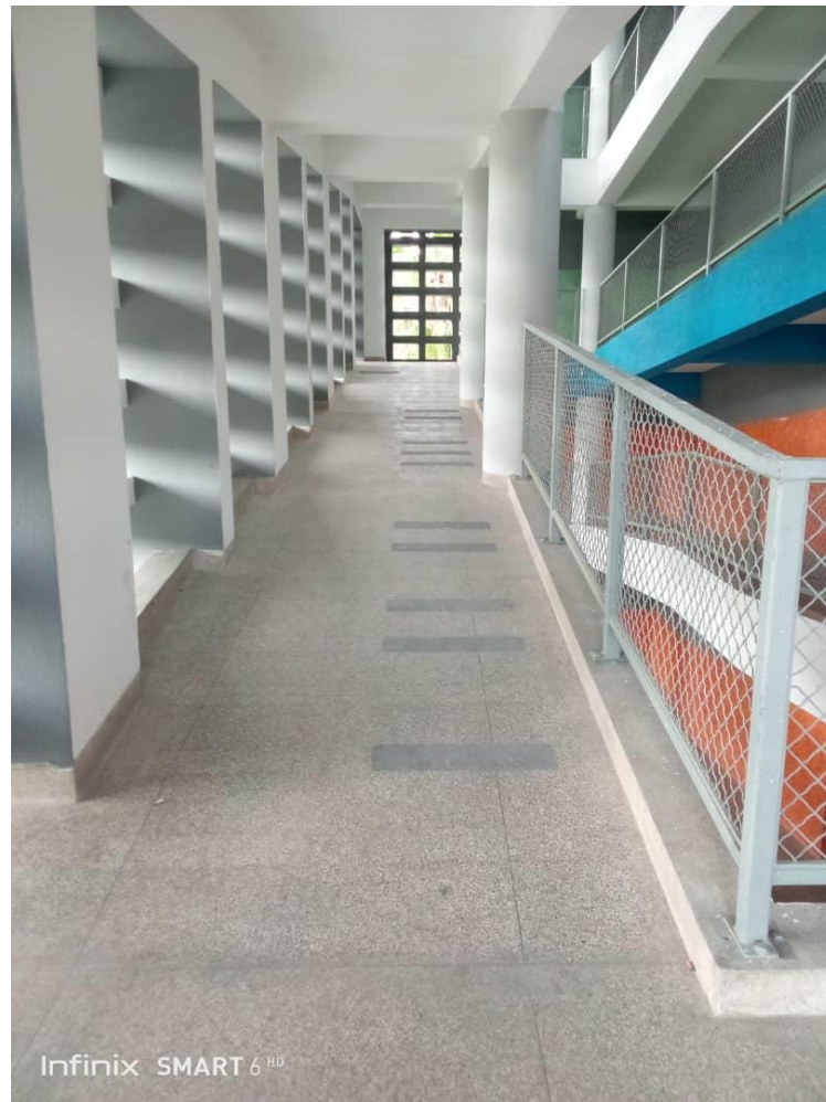
Anexo N° 9. Rampa sureste para el traslado de pacientes y visitantes ante una emergencia.
