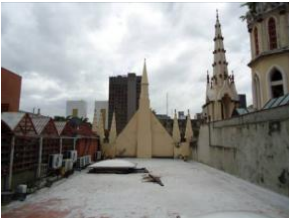
Imágenes 82 y 83: Techos de las naves Norte y Sur con los carateos recientemente improvisados sobre el revestimiento final de baldosas de arcilla para paliar las filtraciones.
