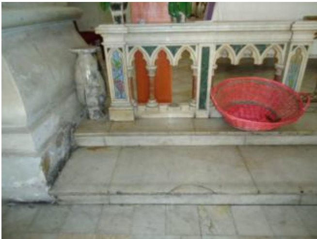
Imagen 91 y 92: Pavimento de mármol de la Nave y del respectivo comulgatorio del cuerpo Norte. En ambos se presentan roturas puntuales.
