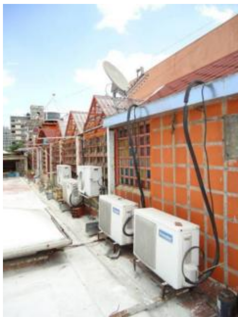
Imagen 86: Equipos de aire acondicionado de la Casa Rectoral cuyos drenajes evacuan hacia el techo de la Nave Sur.
