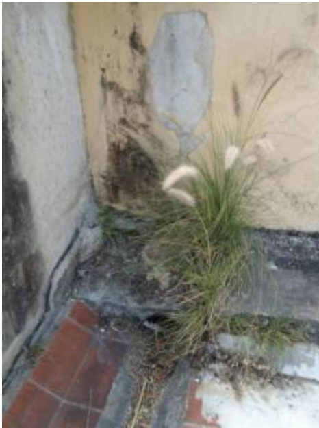
Imagen 84 y 85: Techos de las naves Norte y Sur. Presencia de formaciones herbáceas en canales y bocas de bajantes.
