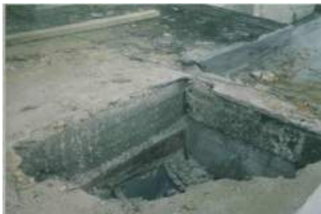
Imagen 98: Detalle de la rotura de la losa de concreto de la Nave central.
