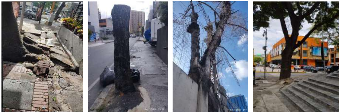
Imagen 6: Árboles existentes en aceras del Eje Norte de las Mercedes, en situación de conflicto y riesgo (2023-2024).
