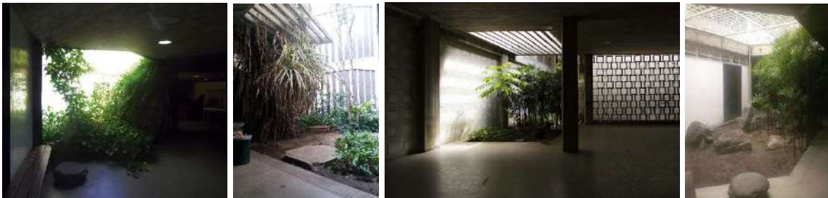
Imagen 3: Jardines internos FAU y el visible deterioro (2017).
