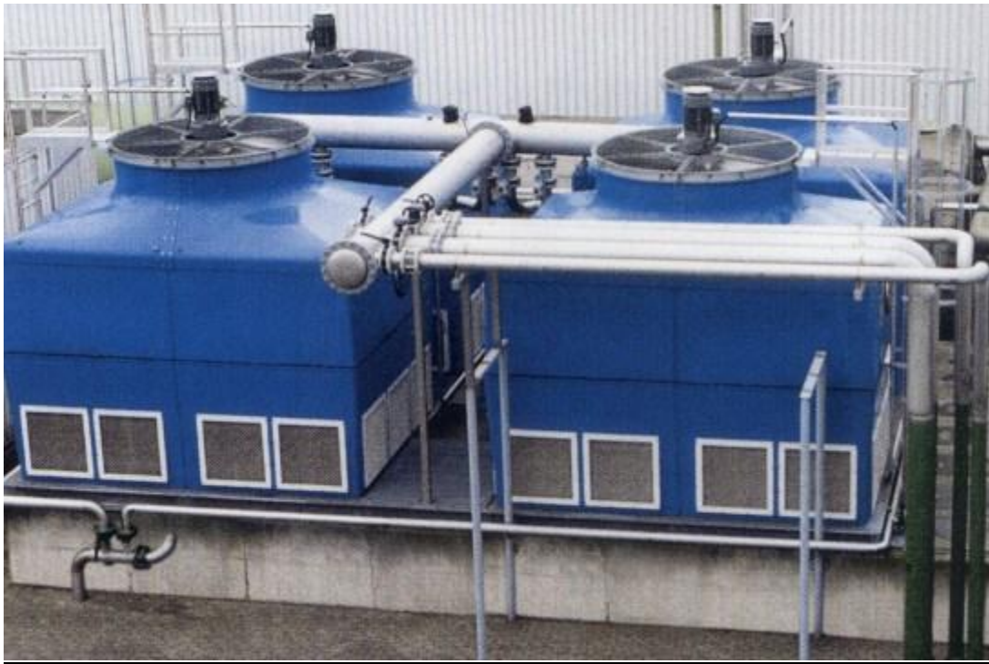
Figura 2.3.7 Torres de enfriamiento.
