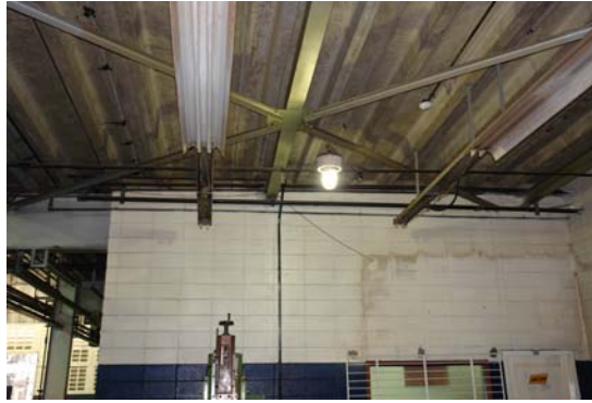
Figura 28. Luminarias defectuosas. Taller de Metales y Máquinas de Herramientas. Refinería El Palito.
