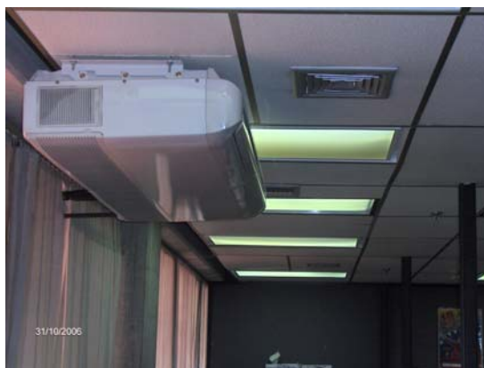
Figura 20. Luminaria obstaculizada por unidad de aire acondicionado. Edificio Sede de Maturín.
