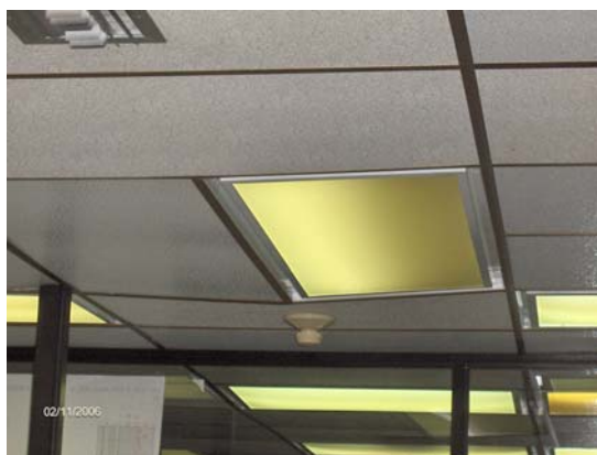
Figura 21. Luminaria mal instalada. Edificio Sede de Maturín.
