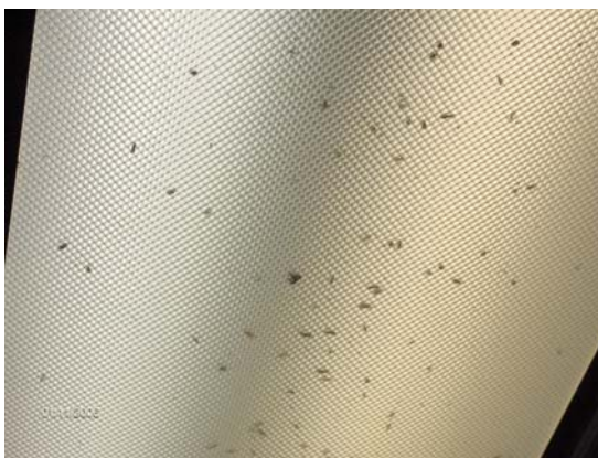
Figura 17. Luminaria sucia. Edificio Sede de Maturín.
