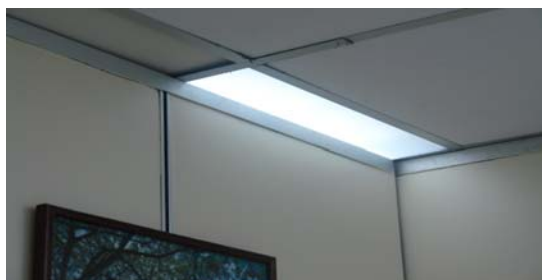
Figura 25. Luminaria seccionada por pared. Edificio Administrativo. Refinería El Palito.
